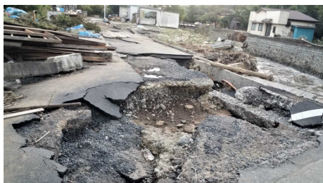
姿川の氾濫で宇都宮市の大谷資料館入り口の道路が崩落=10月14日
