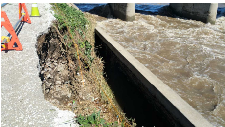
堤防内側がえぐられ危険な状態の宇都宮市下反町町の田川=10月13日
