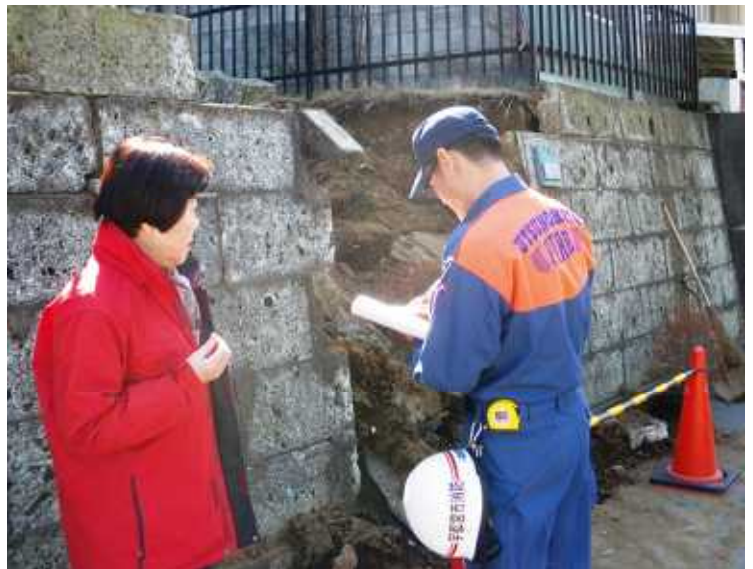
盛り土の壁面が崩れた民家で、消防署員に説明する 野村せつ子県議 = 3月12日、宇都宮市雀宮地域で
